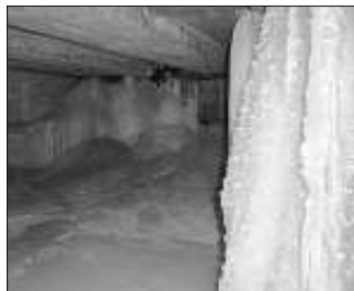
Так выглядят сейчас подвалы панельных домов, из-за прорыва разорванной системы отопления.
